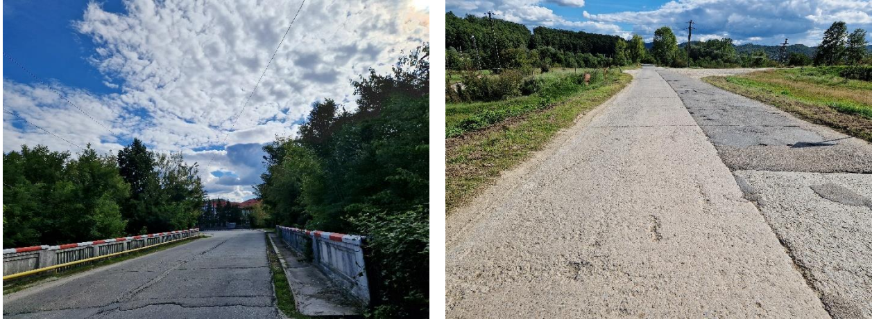
Figura 2.24. Străzi a căror suprafață de rulare se află în stare tehnică necorespunzătoare (exemplificare).
