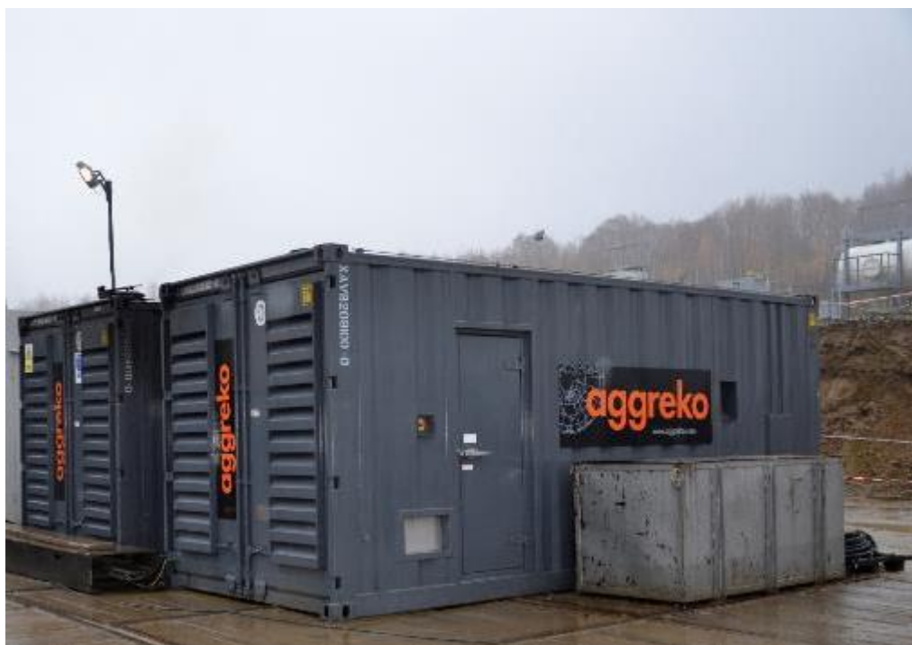
Figura nr. 1-5 Generatoarele electrice ce urmează a fi folosite în cadrul proiectului, amplasate pe una din locațiile Amromco S.R.L
