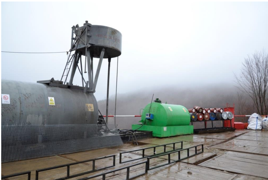
Figura nr. 1-4 Rezervor de motorină amplasat pe una din locațiile Amromco Energy SRL
