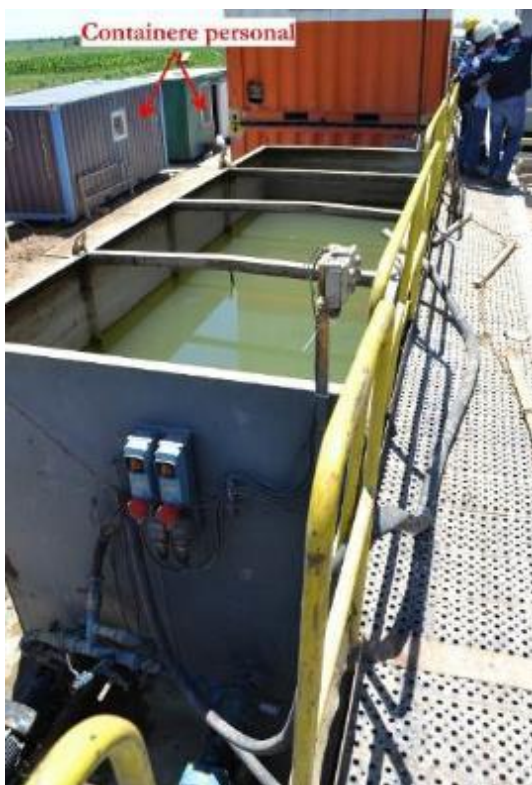
Figura nr. 1-2 Model de habă de apă amplasată pe una din locațiile Amromco Energy SRL
